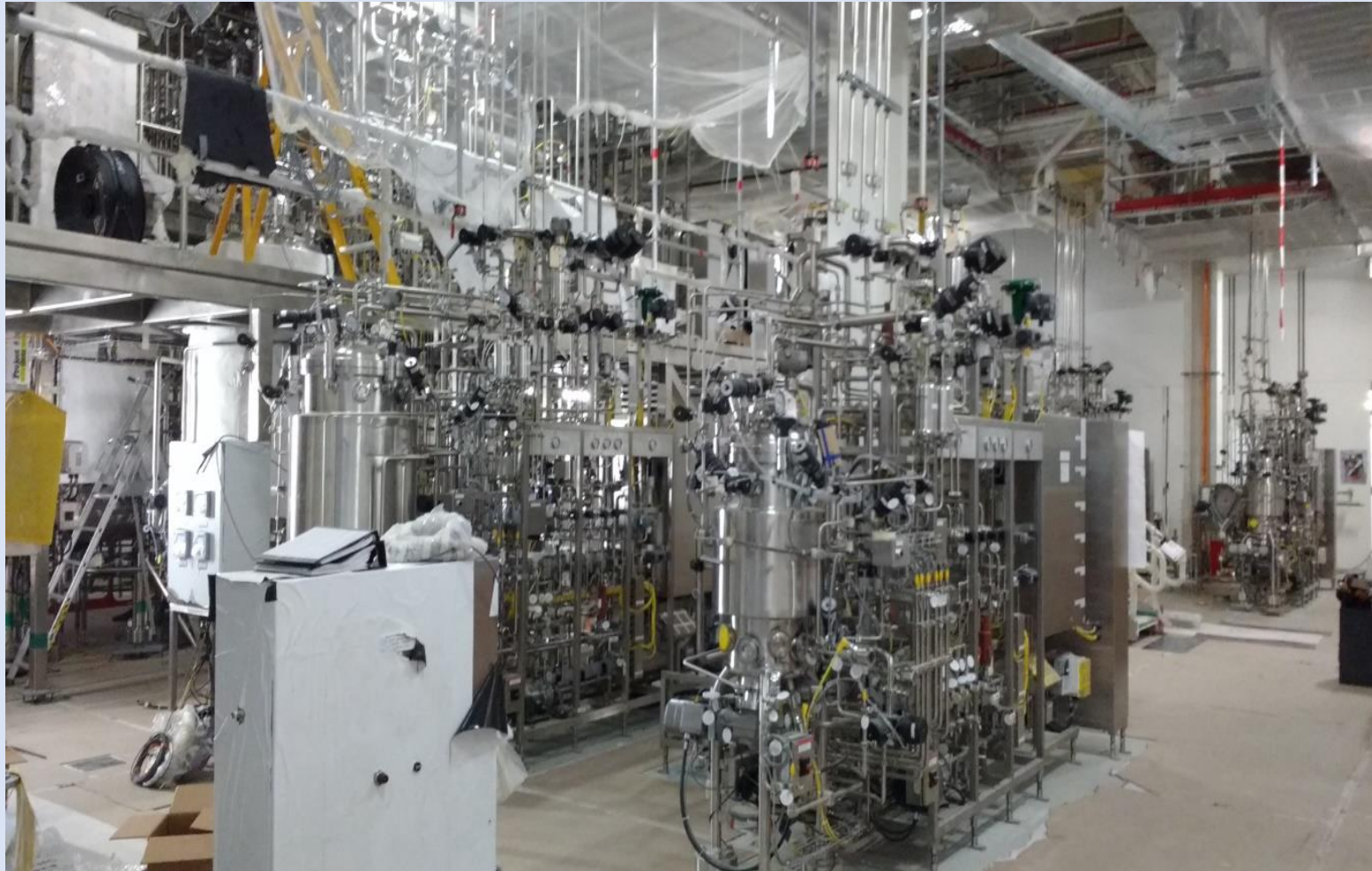
Gedeelte productieinstallatie, Convoi Schweiz, Lüterbach, CH.
